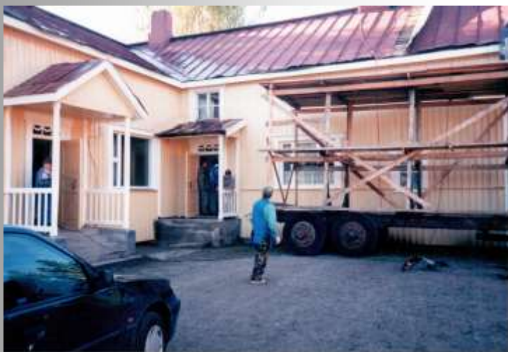
1997 talon vesikatto pihan puolelta uusittiin. Vanha pelti oli vahva, mutta ei ollut kestänyt jokatalvista kovakouraista jään poistamista.
